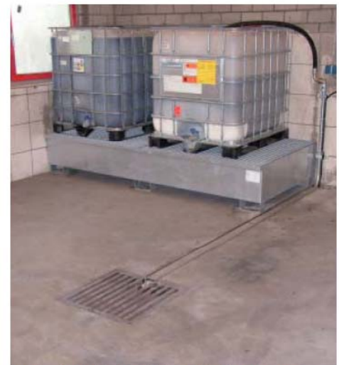
Fertige Bodenfläche, IBC's auf Auffangwanne
