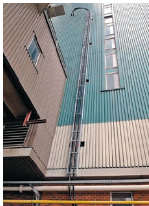
Steigleitung an der Rauchgasreinigungsanlage
