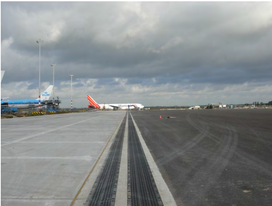
Pier J, Neubau 2006 mit Rinnensystem BIRCO SIR 500 (rechts) und BIRCO SIR 400 (links)
