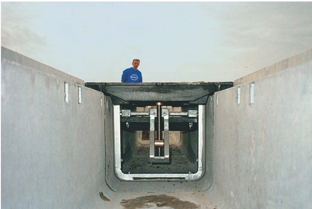
Pier J, Neubau 2006, Rinnensystem BIRCO SIR 500 mit Absperrvorrichtung
