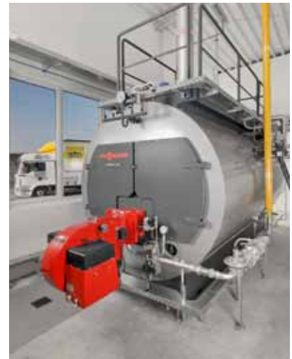
StoVerotec produziert mit neuer Industrie-Anlage Hochdruck Dampf - einem Vitomax 200 von Viessmann.
