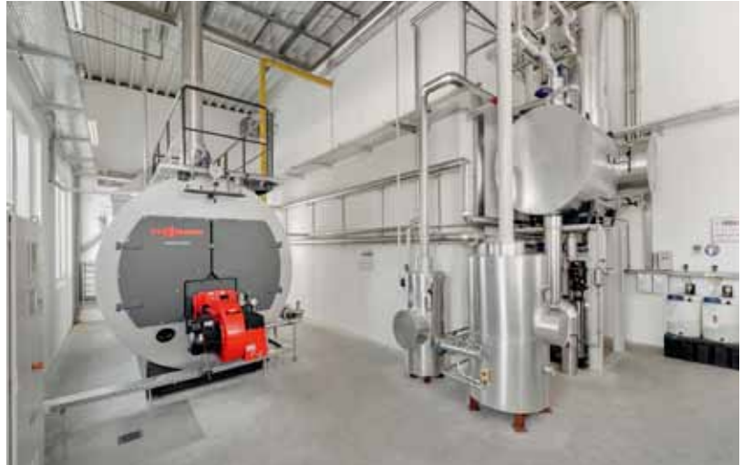
Zuverlässig und effizient - die Viessmann Komplettlösung mit ideal aufeinander abgestimmten Komponenten bietet genügend Leistungsreserven für künftige Erweiterungen.
